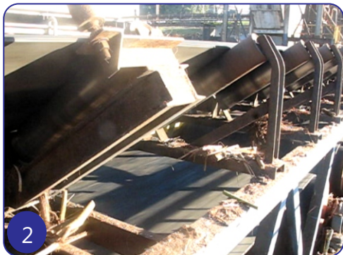
Local onde o trabalhador caiu.
